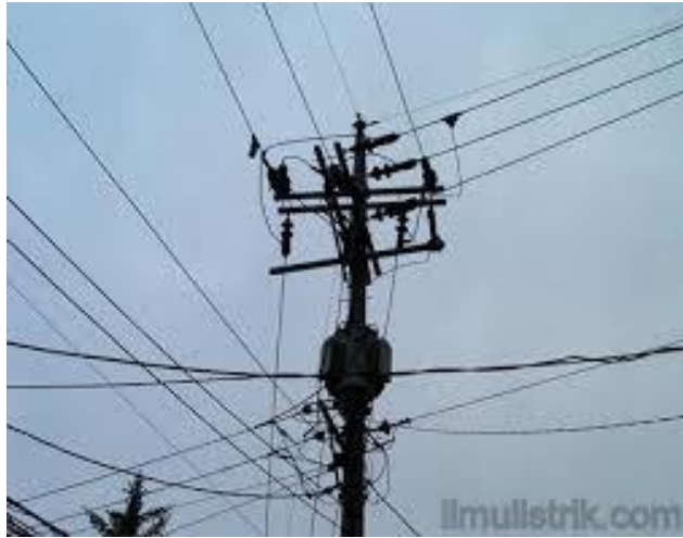
Gambar 2.1 Saluran Kabel Udara Tegangan Menengah Sumber : hudaya.wordpress.com
