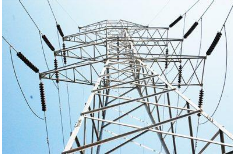
Gambar 2.2 Saluran Udara Tegangan Tinggi
