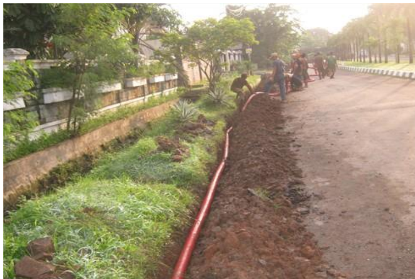
Gambar 2.5 Saluran Kabel Tegangan Menengah
