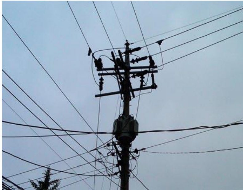
Gambar 2.4 Saluran Kabel Udara Tegangan Menengah
