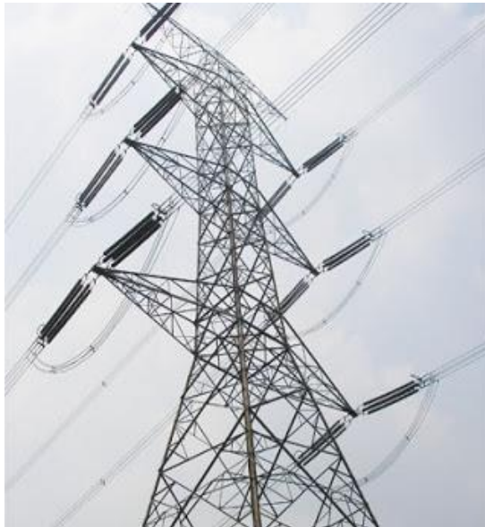
Gambar 2.1 Saluran Udara Tegangan Ekstra Tinggi
