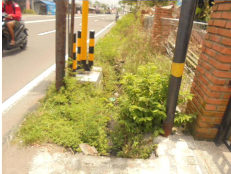
Gambar 4.15 Keadaan Saluran Drainase Yang Tidak Terawat
