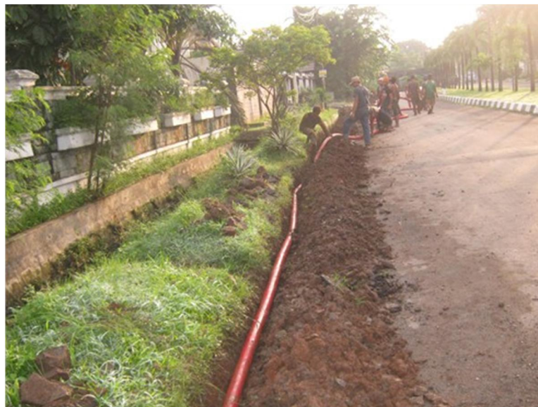
Gambar 2.5 Saluran kabel tegangan menengah
