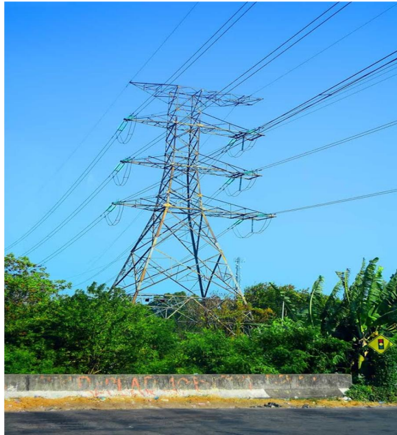
Gambar 2.1 Saluran udara tegangan ekstra tinggi
