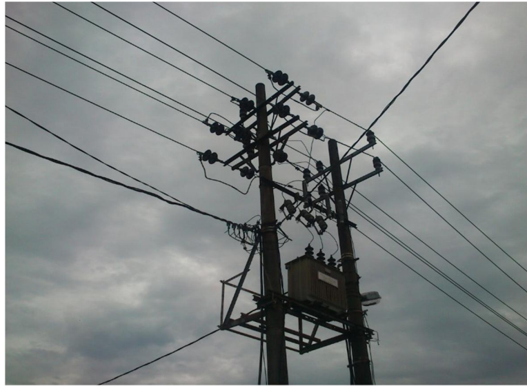
Gambar 2.4 Saluran Kabel udara tegangan menengah
