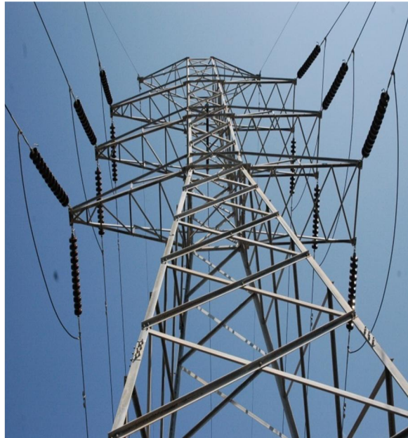
Gambar 2.2 Saluran udara tegangan tinggi
