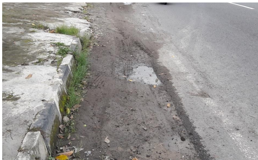
Gambar 5.2. Foto Keadaan Bahu Jalan yang Rusak Pada ruas jalan Yogyakarta - Magelang KM 11.5
