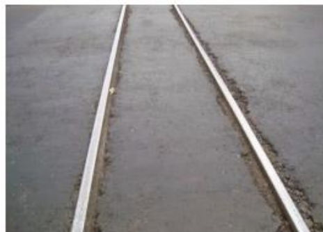
Gambar 13 Kerusakan pada perpotongan rel Sumber : Bina marga No. 03/MN/B/1983 dalam Parmono
