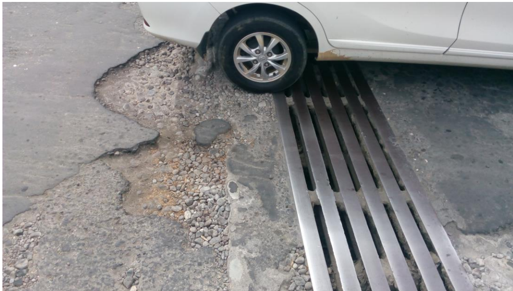
Gambar 1 Kondisi jalan lubang
