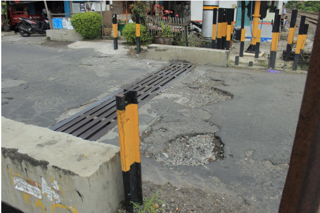
Gambar 3 Kondisi kerusakan lubang
