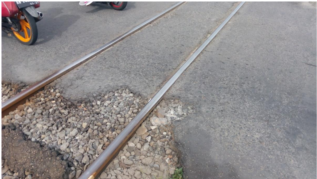
Gambar 4 Kondisi kerusakan pada perpotongan rel
