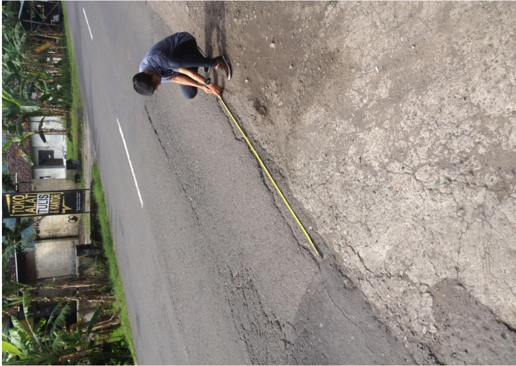
Gambar 8. Kerusakan Retak Pinggir
