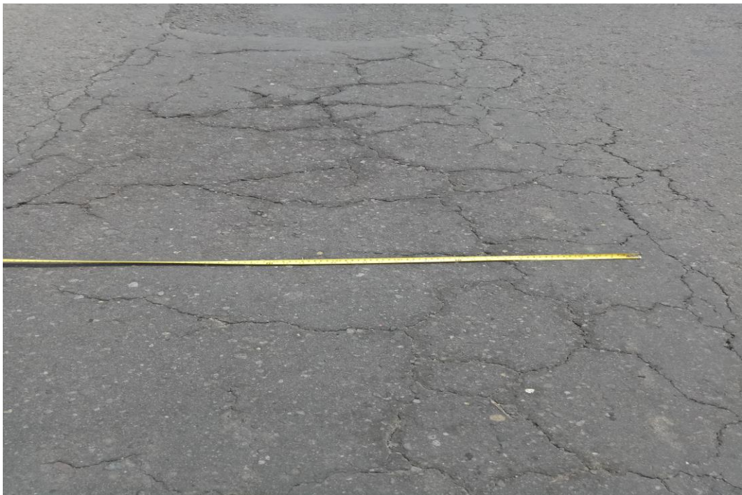
Gambar 4. Kerusakan Retak Block
