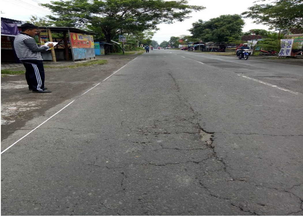
Gambar 1. Kerusakan Retak Memanjang
