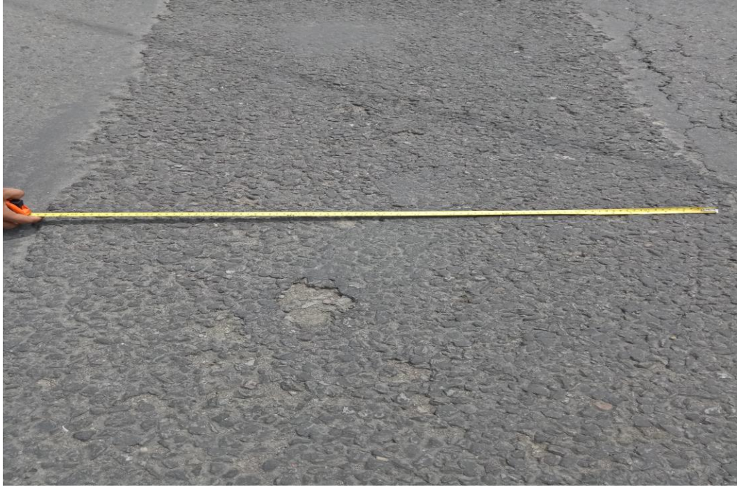
Gambar 3. Kerusakan Pengausan Agregat
