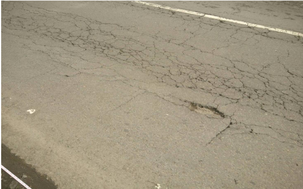
Gambar 5. Kerusakan Retak Kulit Buaya
