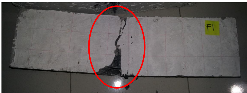
Gambar 5.13 Keretakan balok hasil pengujian tahap II rentan waktu 28 hari (Balok tanpa bakteri)
