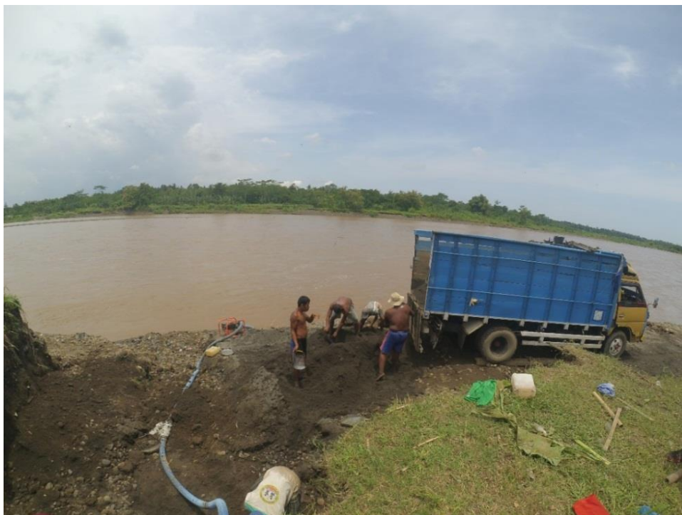
Gambar 1.2 Kegiatan penambangan pasir di sekitar Jembatan Srandakan
