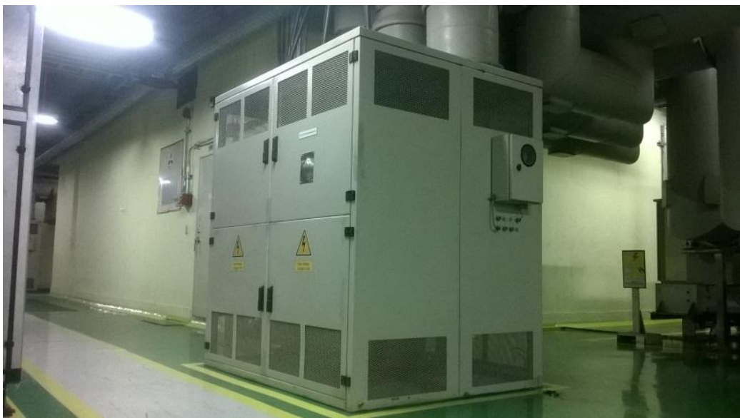
Gambar 4.4 Excitation Transformer Pada PLTA Musi
