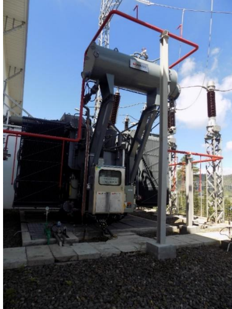
Gambar 4.6. Main Transformer 50 MVA (T21) pada Pembangkit Listrik Tenaga Panas Bumi (PLTP) Kamojang Unit V
