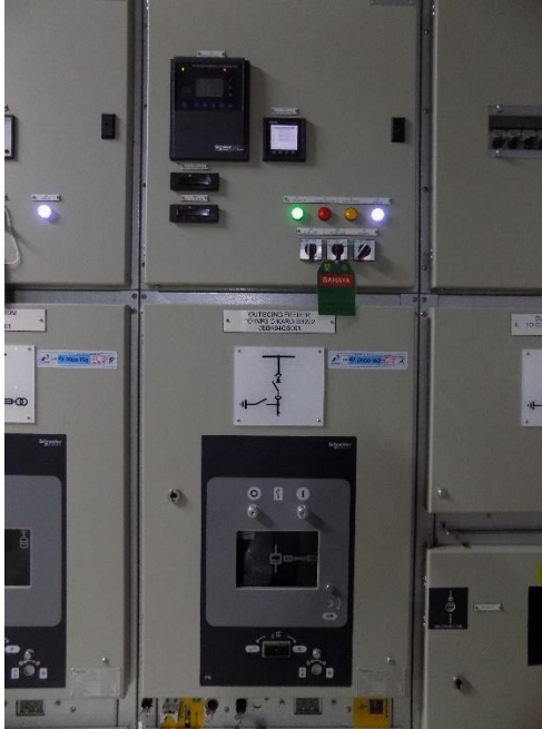
Gambar 4.7. Relay differensial (87GT) pada Pembangkit Listrik Tenaga Panas Bumi (PLTP) Kamojang Unit V
