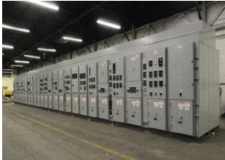
Gambar 2.6 Panel Kontrol Utama.
