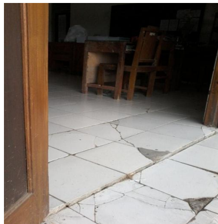
Gambar 5.18 Lantai yang mengalami kerusakan pada SD N Sono
