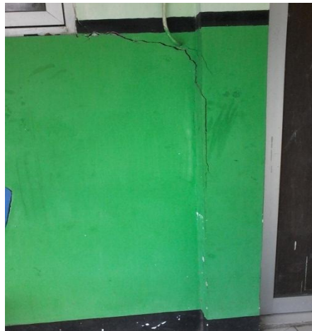
Gambar 5.16 Kolom yang memiliki kerusakan pada SD N Sono
