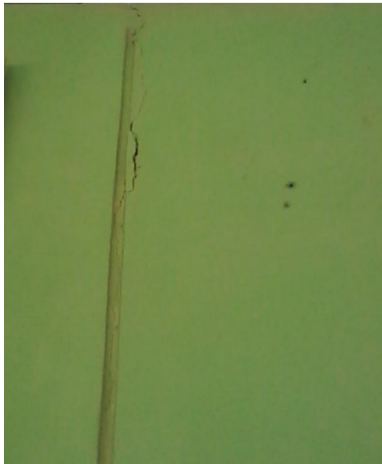
Gambar 5.7 Kolom yang memiliki kerusakan ringan pada SD N Talkondo
