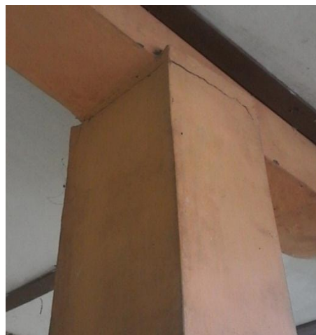
Gambar 5.28 Kolom yang memiliki kerusakan ringan pada SD Muhammadiyah Babakan
