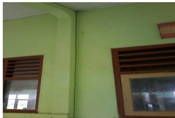
Gambar 5.38 Kolom yang memiliki kerusakan ringan pada SD N Krajan
