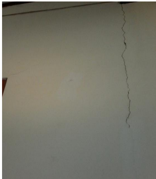
Gambar 5.48 Kolom yang memiliki kerusakan ringan pada SD 2 Parang Tritis
