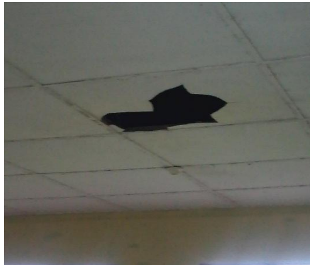
Gambar 5.40 Penutup plafond yang memiliki kerusakan SD N Krajan
