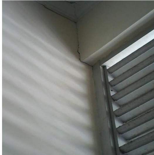
Gambar 5.19 Balok yang mengalami kerusakan pada SD N Sono
