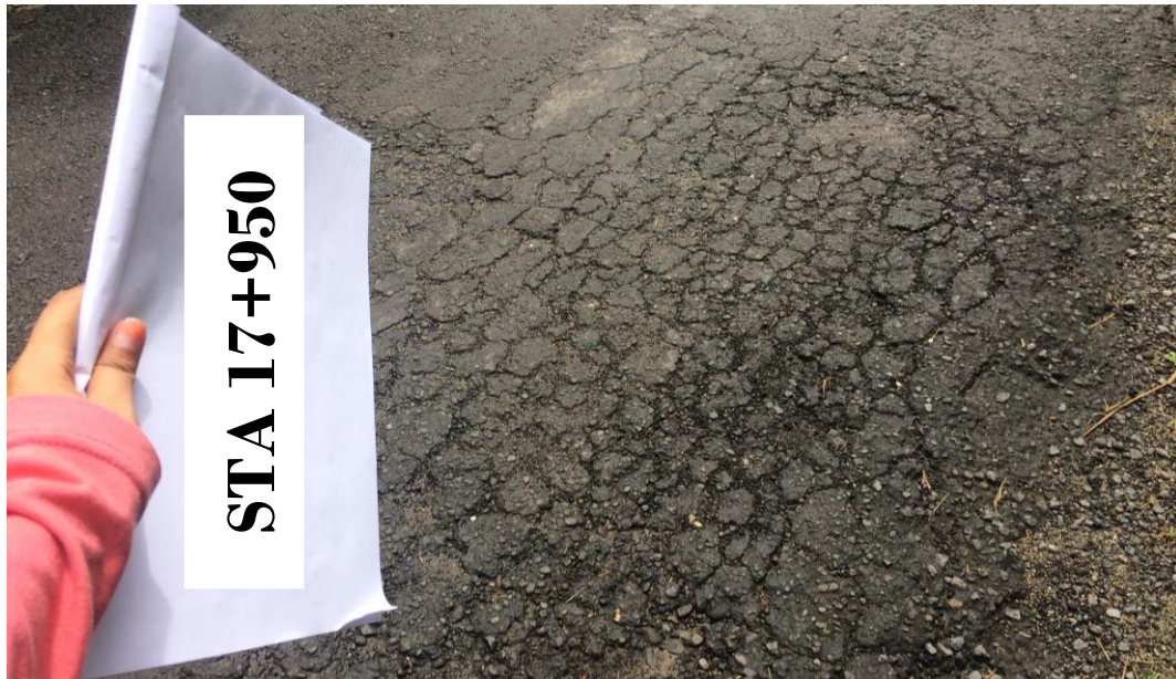
Gambar 2.1 Dokumentasi Kerusakan Retak Kulit Buaya
