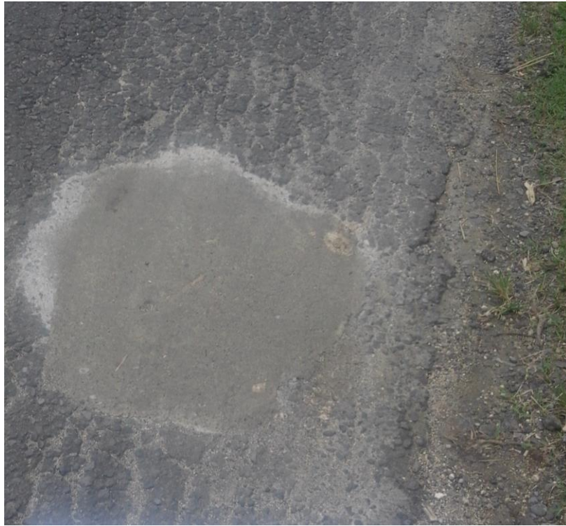
Gambar 2.7 Dokumentasi Kerusakan Tambalan
