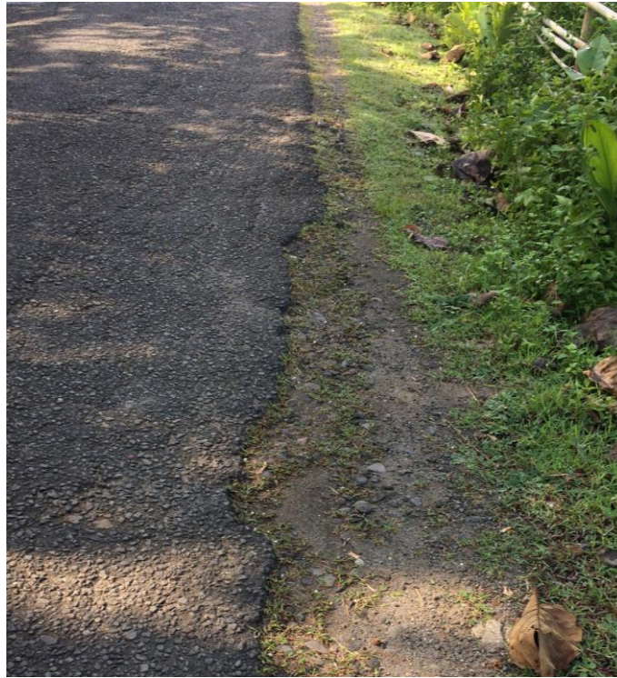
Gambar 2.5 Dokumentasi Kerusakan Retak Pinggir Jalan
