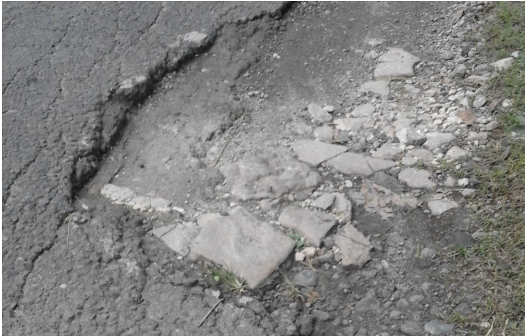
Gambar 2.11 Dokumentasi Kerusakan Patah Slip
