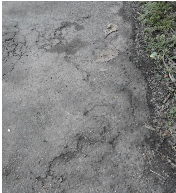
Gambar 2.12 Dokumentasi Kerusakan Mengembang Jembul
