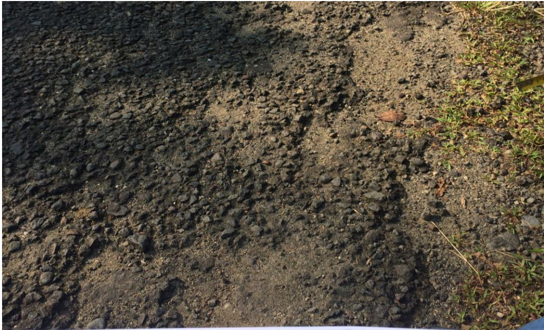
Gambar 2.13 Dokumentasi Kerusakan Pelepasan Butir
