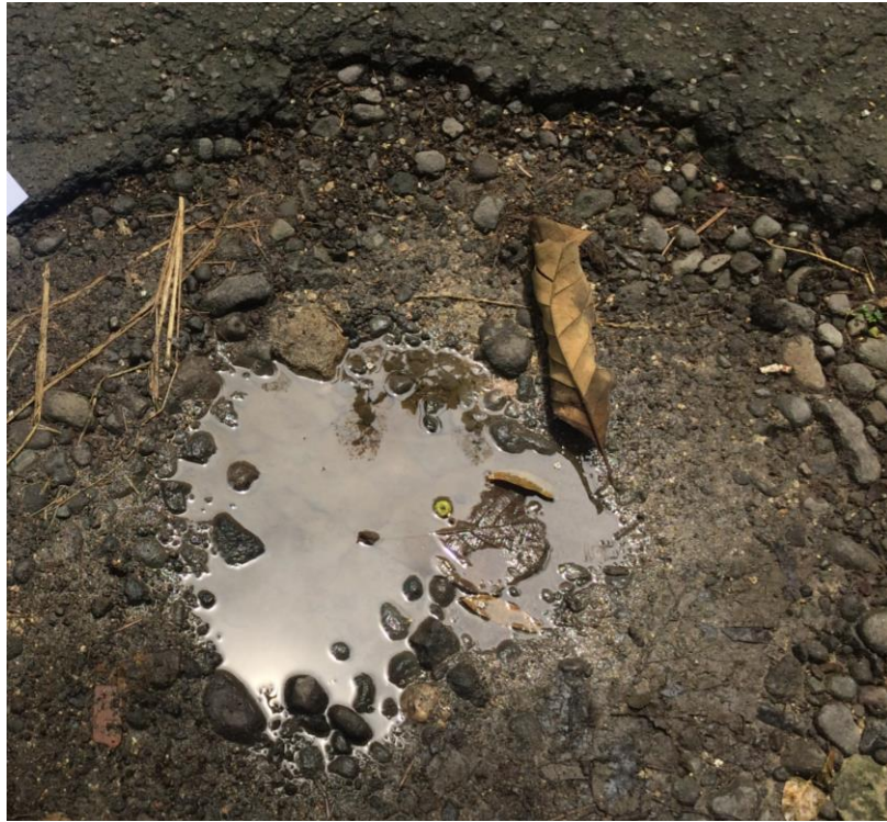
Gambar 2.9 Dokumentasi Kerusakan Lubang
