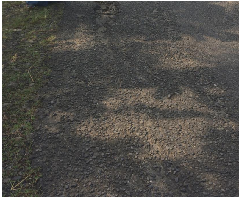
Gambar 2.8 Dokumentasi Kerusakan Pengausan Agregat
