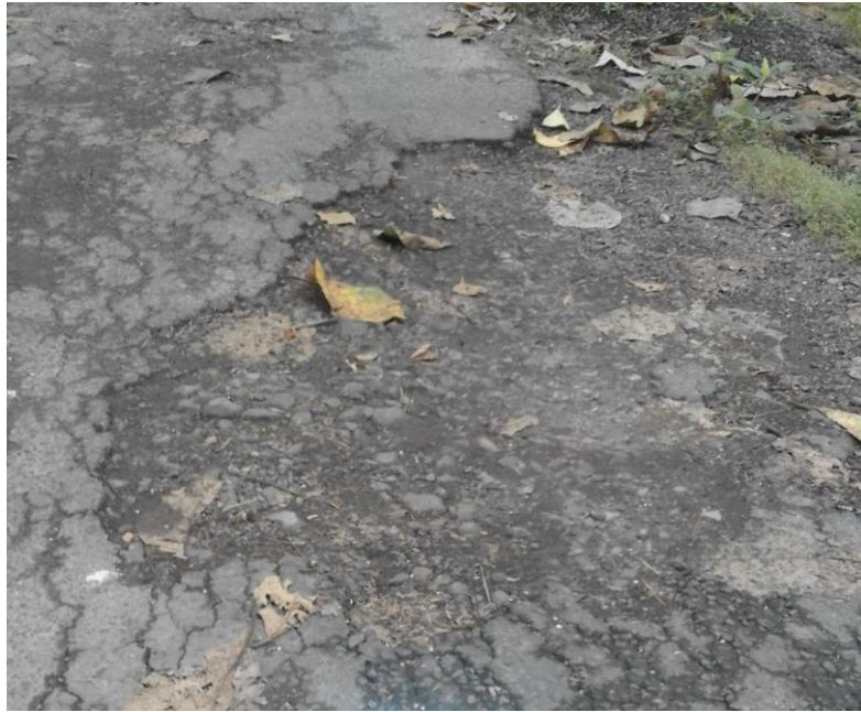
Gambar 2.3 Dokumentasi Kerusakan Keriting
