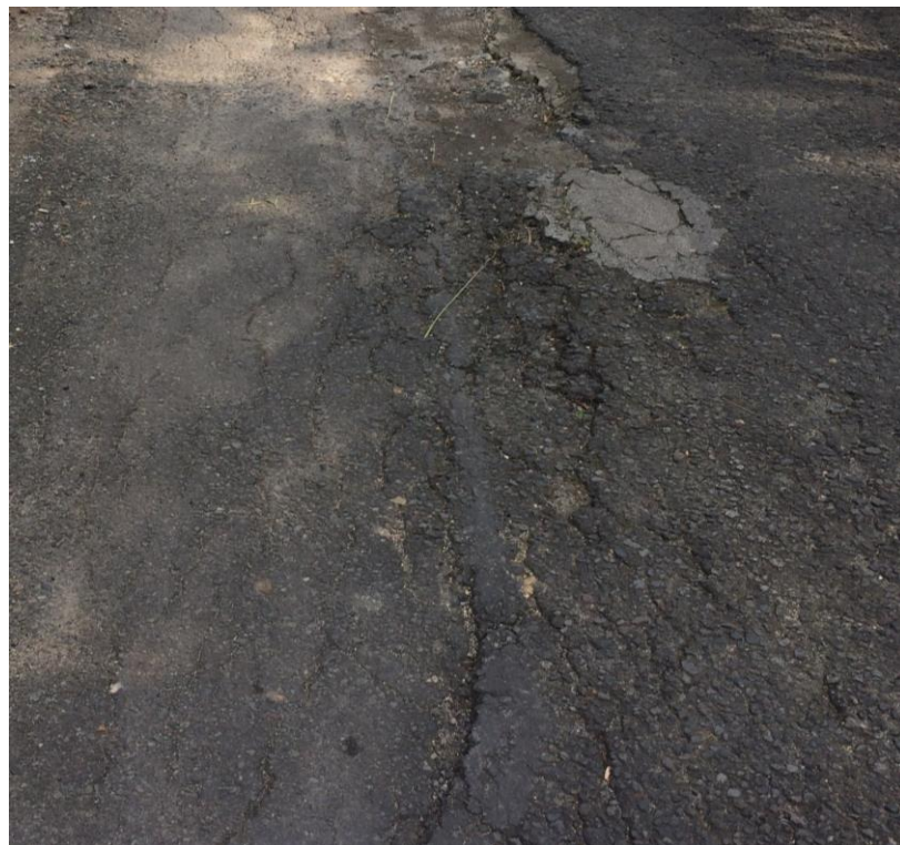
Gambar 2.10 Dokumentasi Kerusakan Sungkur
