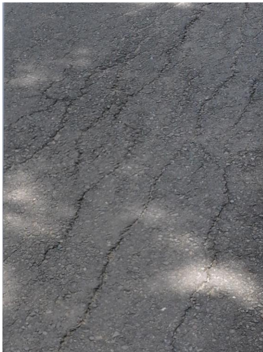
Gambar 2.6 Dokumentasi Kerusakan Retak Memanjang/Melintang
