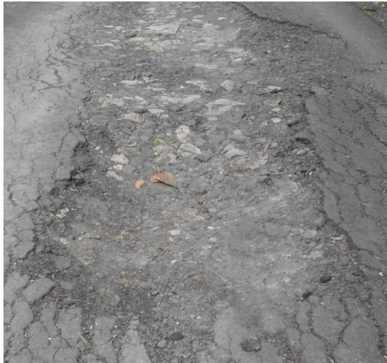
Gambar 2.4 Dokumentasi Kerusakan Amblas
