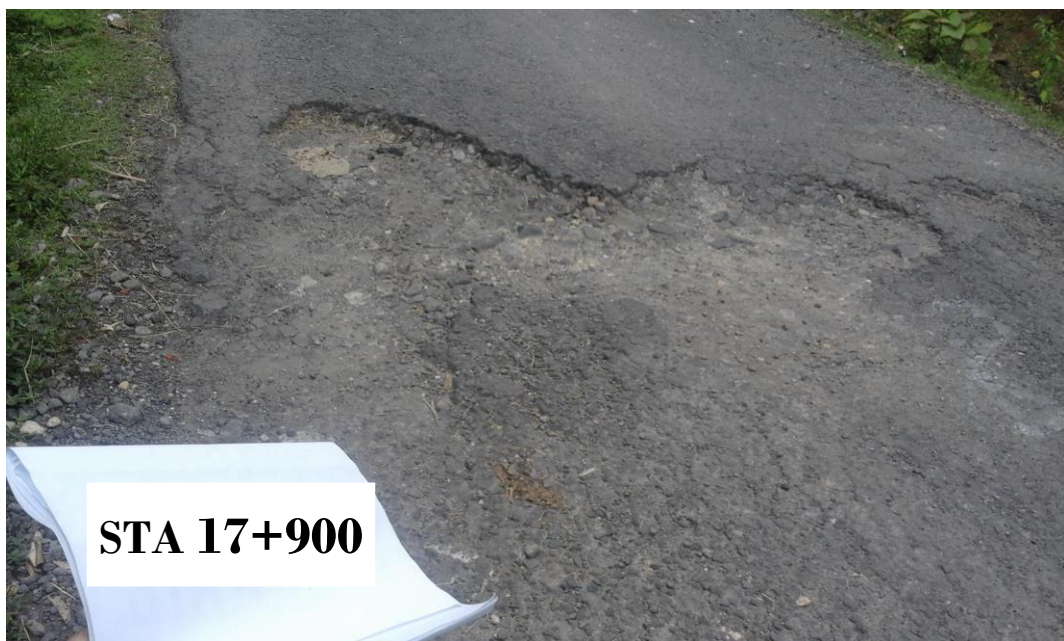
Gambar 2.2 Dokumentasi Kerusakan Cekungan
