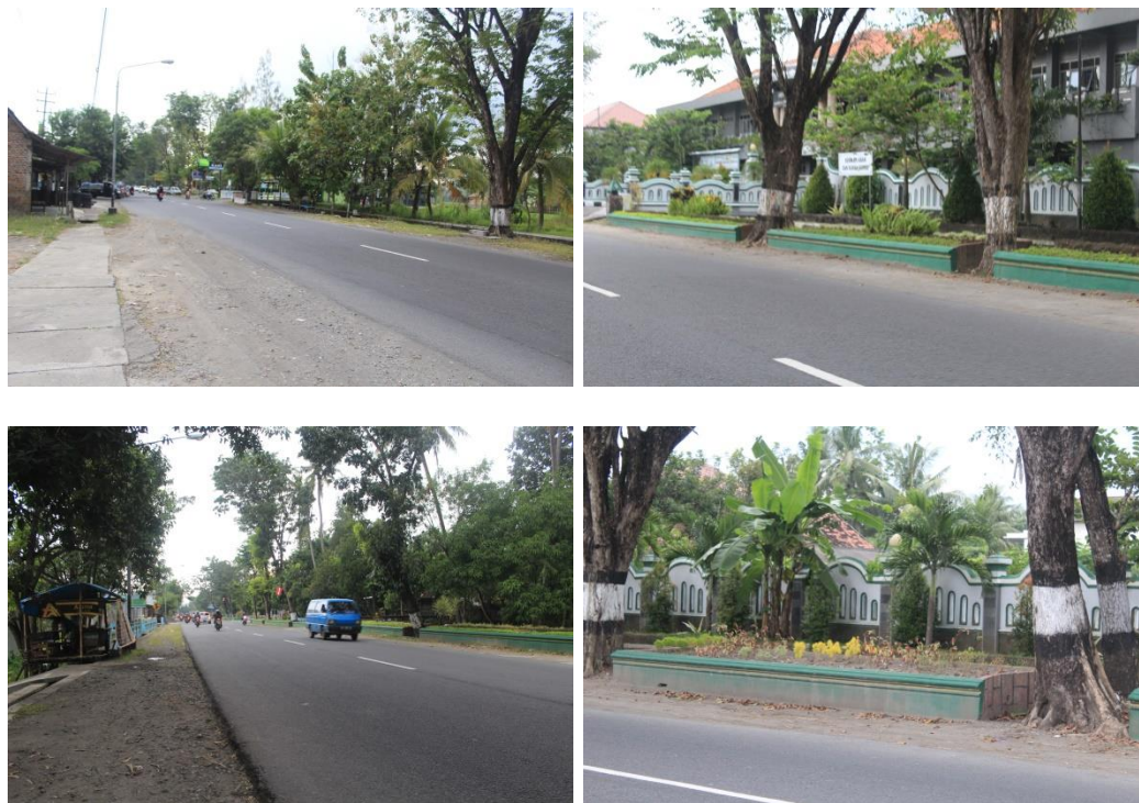
Gambar 7. Kondisi jalan KH. Wahid Hasyim
