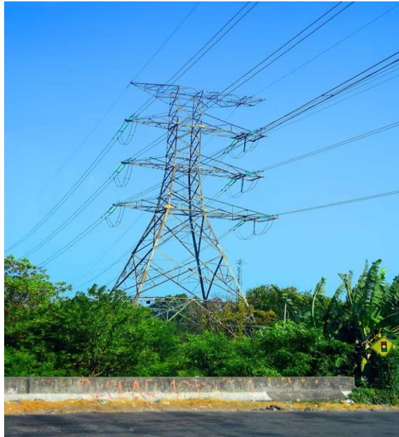
Gambar 2.1 Saluran udara tegangan ekstra tinggi
