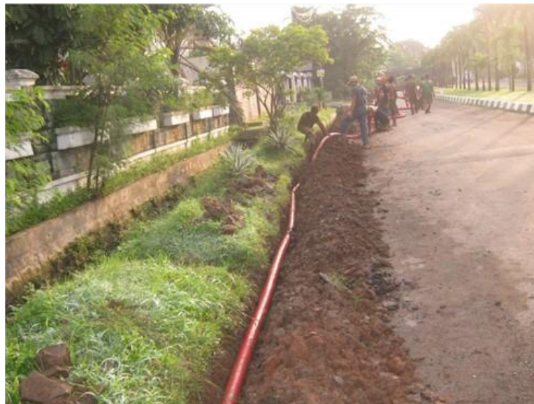
Gambar 2.5 Saluran kabel tegangan menengah
