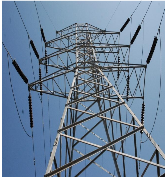
Gambar 2.2 Saluran udara tegangan tinggi
