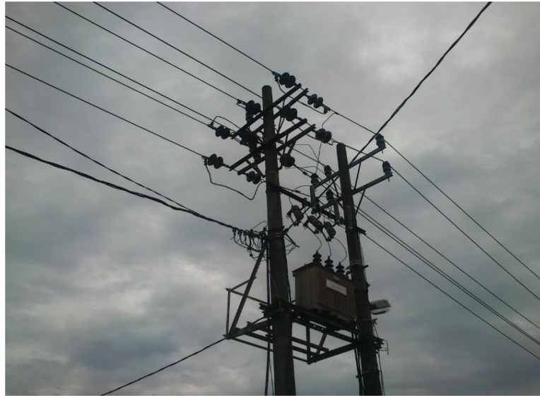
Gambar 2.4 Saluran Kabel udara tegangan menengah
