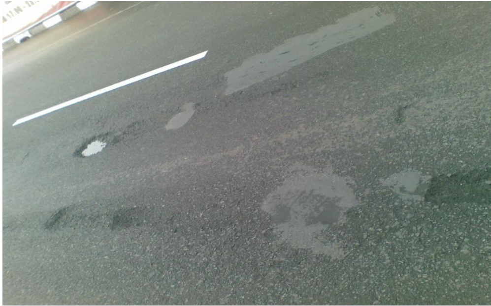
Gambar 5.18 Kondisi Jalan yang Berlubang
