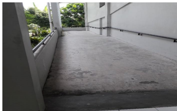
Gambar 3.5 Jalur Khusus dan Pegangan Tangan di Dinding bagi Penyandang Disabilitas
