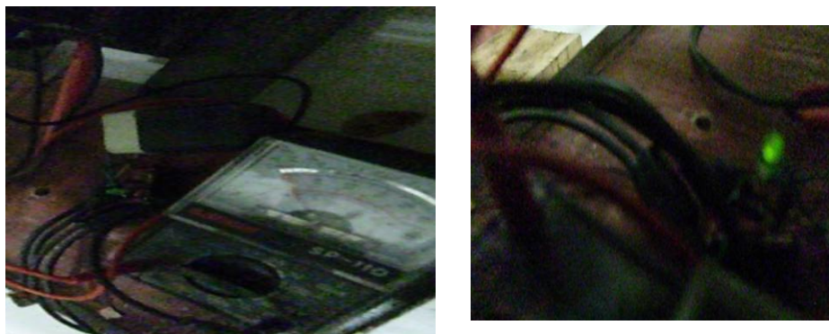
Gambar 3.10. Pengecekan tegangan dan arus output generator.
