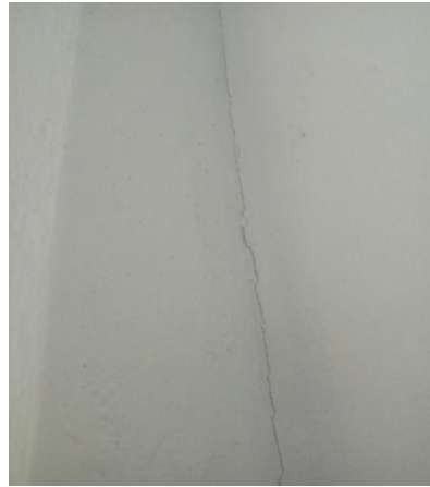
Gambar 5.48 Dinding retak dibatas kolom dan dinding SD N Gungan
