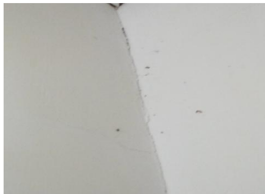
Gambar 5.20 Kerusakan dinding retak dibatas kolom dan dinding SD N Umbulharjo
