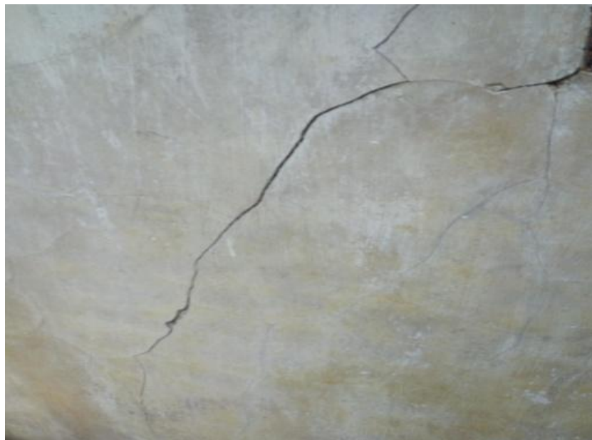
Gambar 5.18 Retakan pada dinding SD N Umbulharjo
