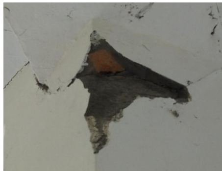
Gambar 5.46 Retakan pada kolom SD N Gungan
