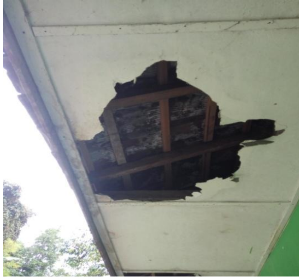
Gambar 5.23 Kerusakan rangka plafon dan penutup plafon SD N Umbulharjo
