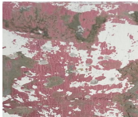
Gambar 5.37 Kerusakan cat dinding SD Muhammadiyah Kregan
