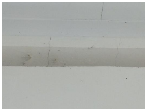
Gambar 5.49 Kerusakan pada balok SD N Gungan
