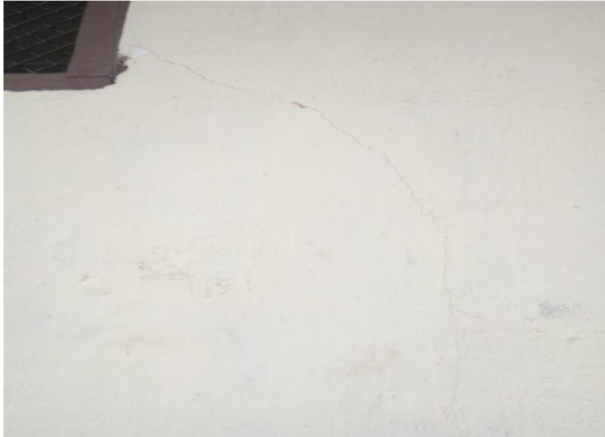
Gambar 5.61 Kerusakan dinding retak diagonal SD N Cancangan
