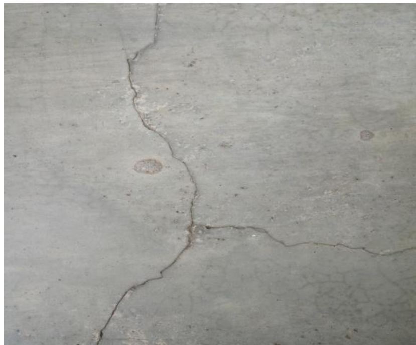
Gambar 5.34 Kerusakan plat lantai SD Muhammadiyah Kregan
