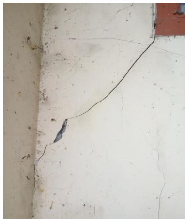
Gambar 5.32 Kerusakan pada dinding SD Muhammadiyah Kregan
