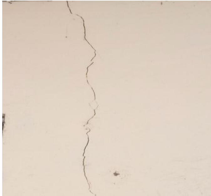
Gambar 5.6 Kerusakan dinding retak diagonal SD N Watuadeg
