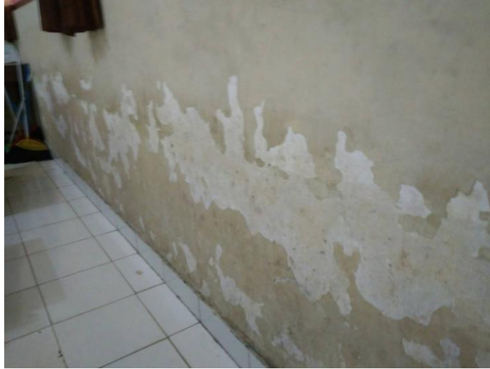
Gambar 5.9 Kerusakan cat dinding SD N Watuadeg
