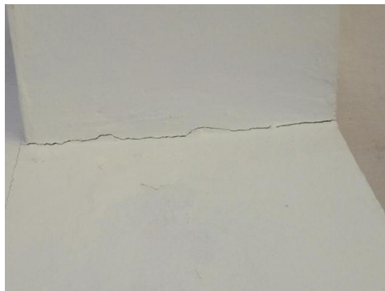
Gambar 5.59 Retakan pada sambungan balok kolom SD N Cancangan
