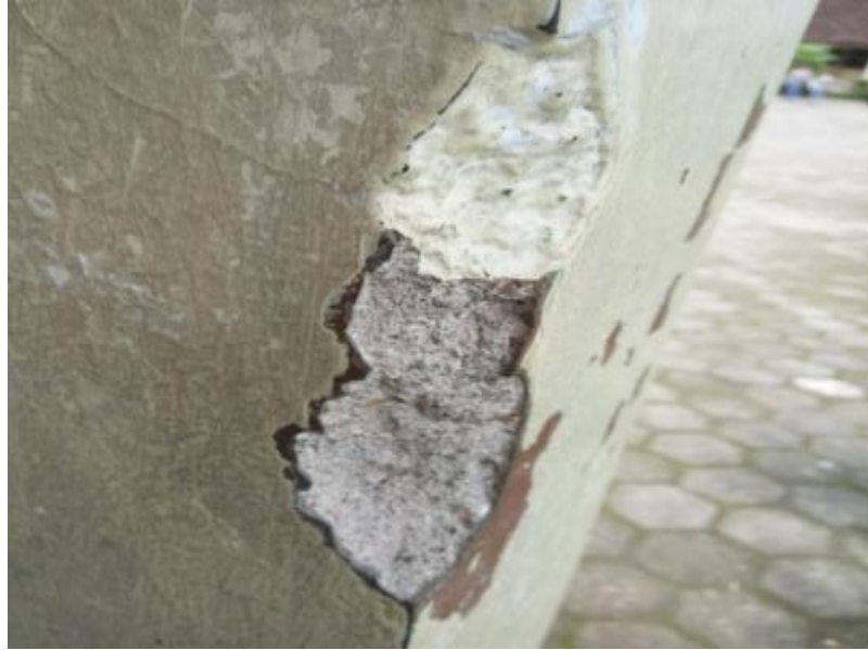
Gambar 5.63 Kerusakan pada kolom SD N Cancangan
