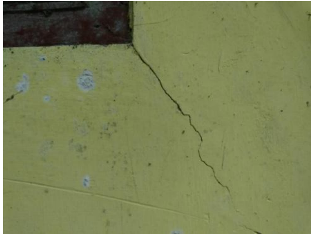
Gambar 5.4 Retakan pada dinding SD N Watuadeg
