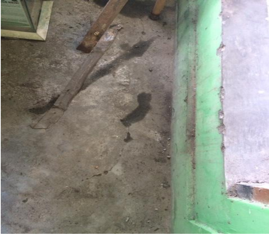
Gambar 1.3. Elevasi lantai gudang lebih rendah dari ruang kelas lainnya
