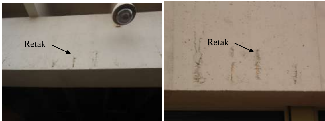
Gambar 8. Retak pada Balok di Terminal 1C Shopping Arcade Sebelah Kiri Area Breakdown
