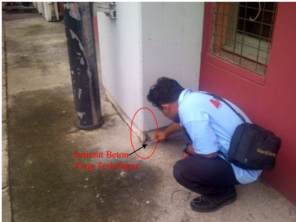
Gambar 10. Retak pada kolom Terminal 1A Shopping Arcade Sebelah Kiri Area Breakdown
