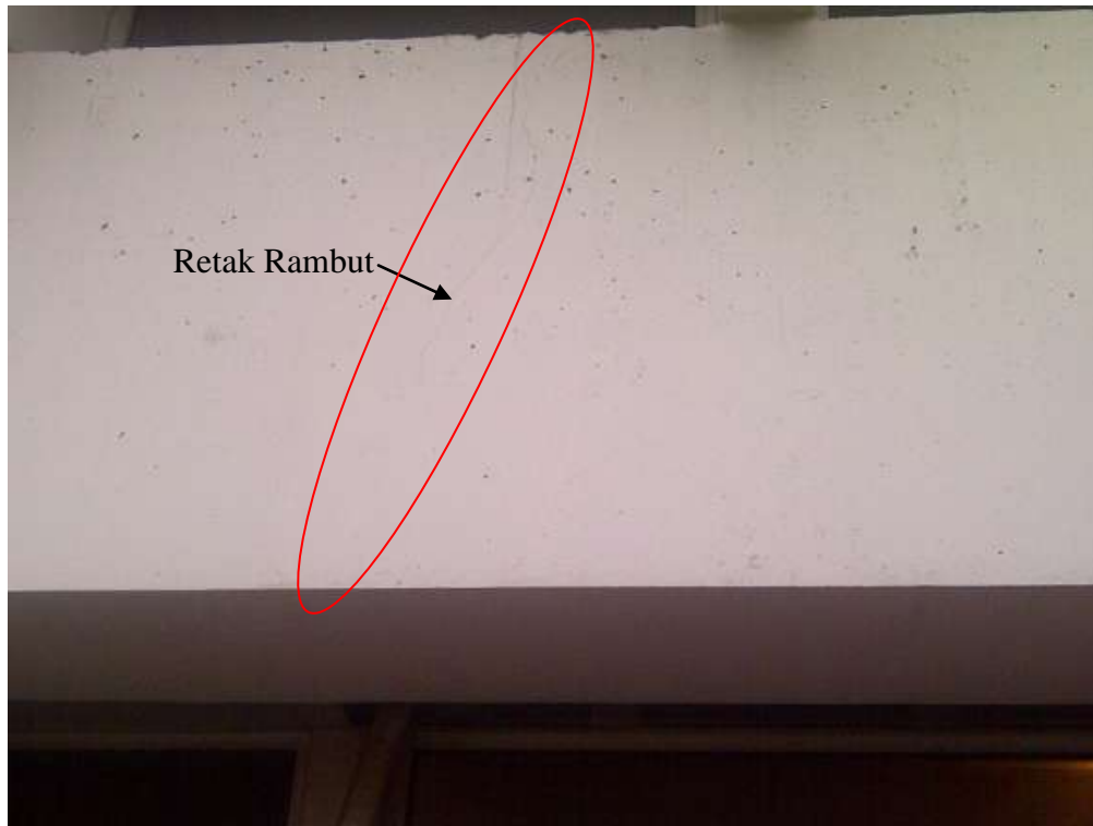
Gambar 9. Retak pada Balok di Terminal 1A Shopping Arcade Sebelah Kiri Area Breakdown
