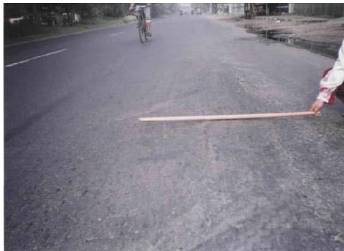
Gambar 2.38 Mengembang Jembul (Swell) Sumber : Bina marga no.03/MN/B/1983
