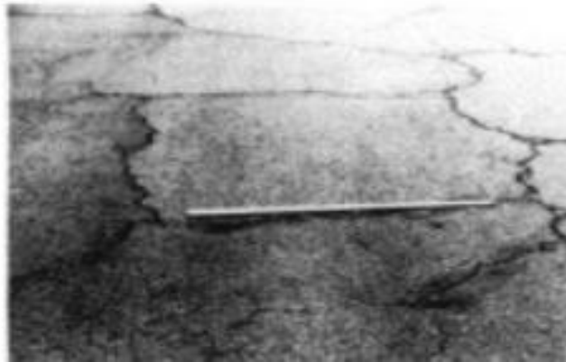
Gambar 2.9 Retak Kotak-kotak ( Block Cracking ) Sumber : Bina marga no.03/MN/B/1983
