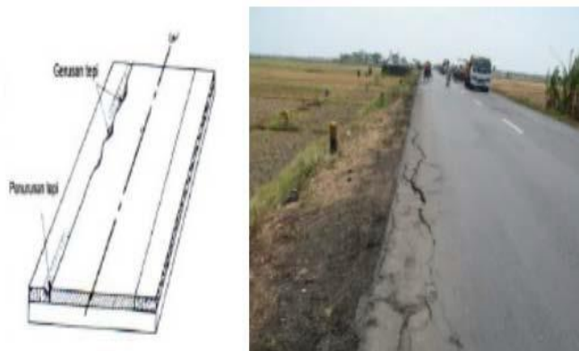
Gambar 2.17 Retak Samping Jalan ( Edge Cracking ) Sumber : Bina marga no.03/MN/B/1983
