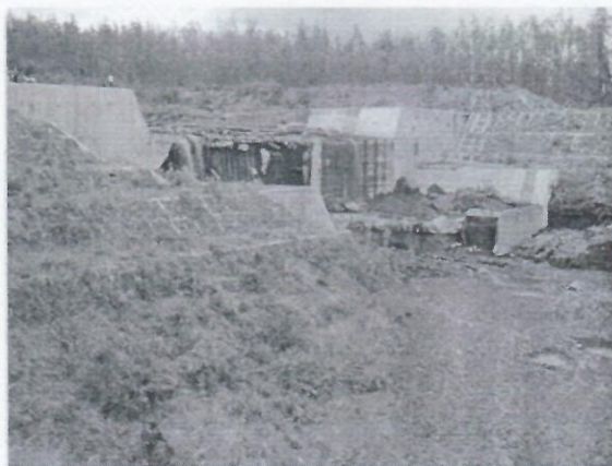
Gambar 3. Salah satu sabo dam di Kali Putih yang rusak oleh banjir lahar dingin
