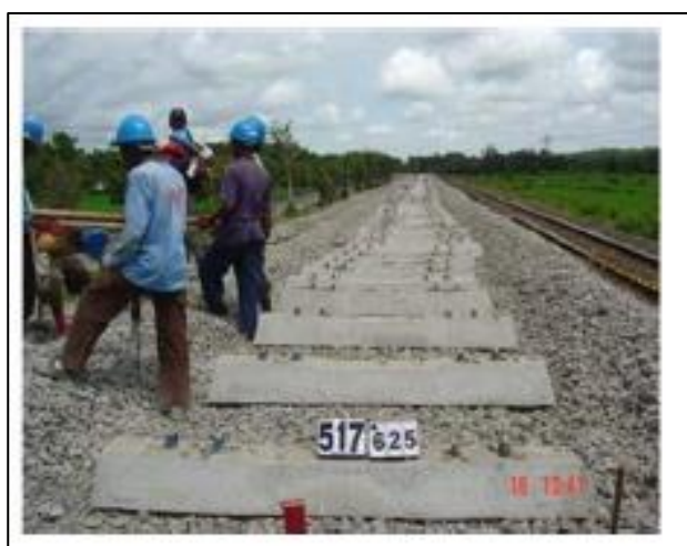
Gambar Error! No text of specified style in document..32 Pekerjaan pemasangan bantalan beton
