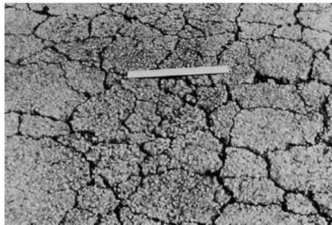
Gambar 3.1 Retak Kulit Buaya ( Alligator Cracking )
