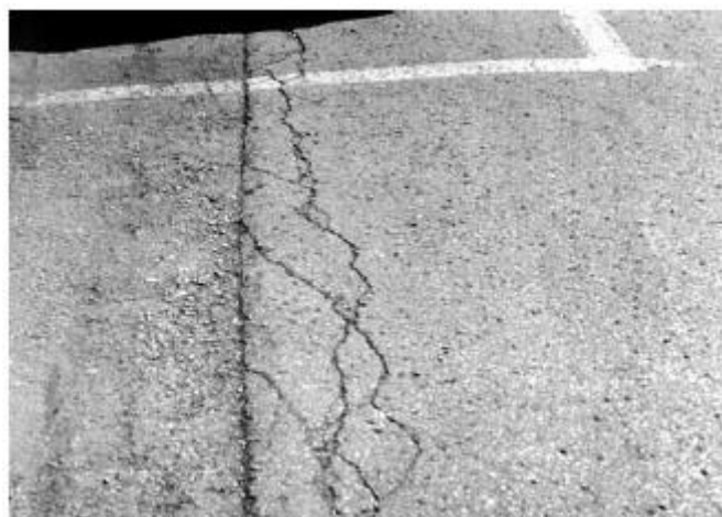
Gambar 3.13 Retak Pinggir ( Edge Cracking )
