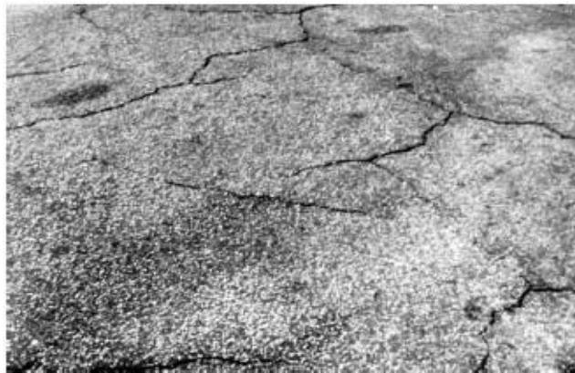
Gambar 3.5 Retak Kotak-kotak ( Block Cracking )
