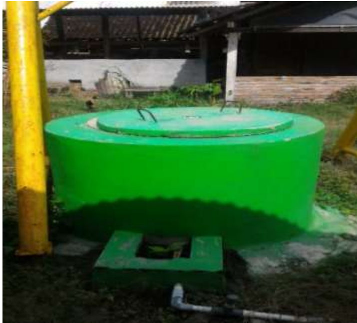
Gambar 3.2. Digester yang digunakan untuk pengolahan kotoran sapi
