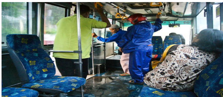
Gambar 5.3 Air Hujan yang masuk ke Area Penumpang
