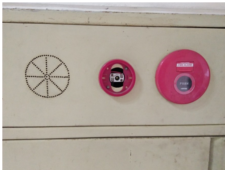
Gambar 5.8 deteksi dan alarm
