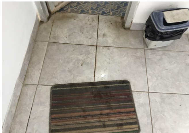
Gambar 3.2 Kondisi lantai pintu masuk toilet puskesmas.
