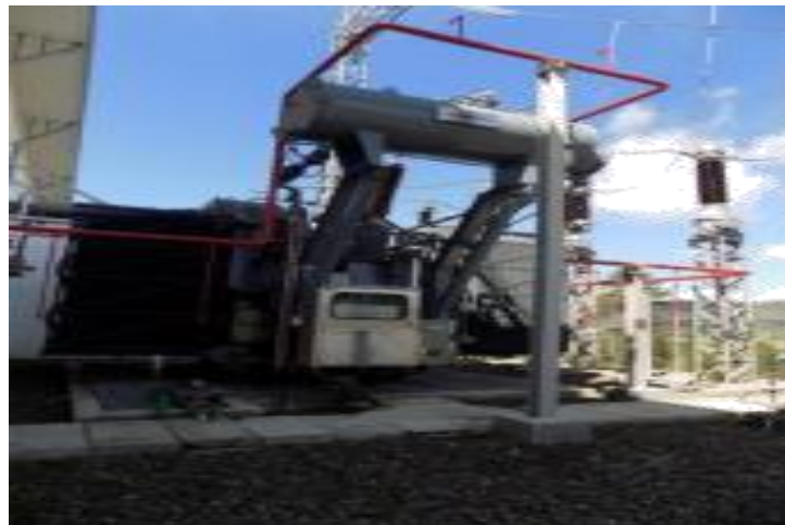
2.1 Main Transformer 80 MVA pada Pembangkit Listrik Tenaga Panas Bumi (PLTP) Kamojang Unit 4
