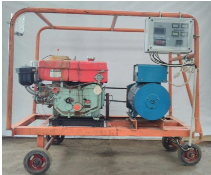
Gambar 3.1 Mesin diesel dan generator
