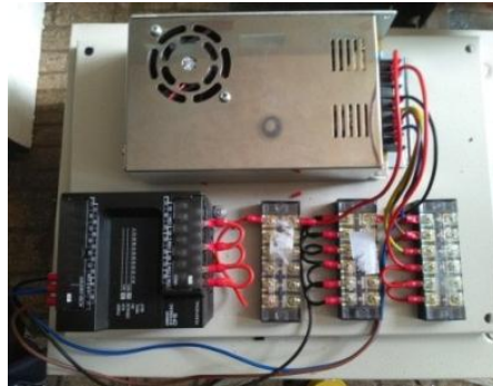
Gambar 4.40 Hasil perakitan Sistem PLC
