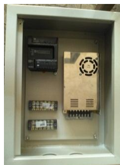
Gambar 4.39 Prakitan Komponen PLC
