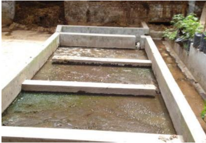
Gambar 13. Instalasi Pengolahan Limbah Ternak di Desa Kepuharjo Sebelum Erupsi 2010
