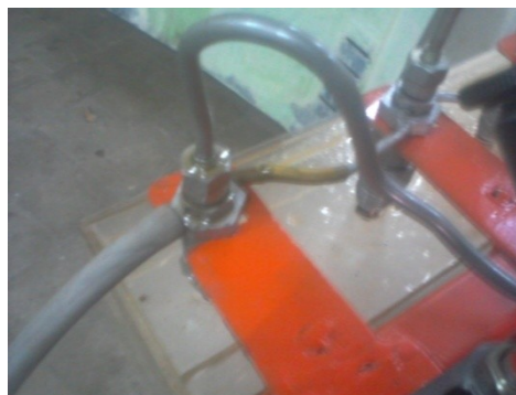
Gambar. 4.33. Kebocoran solar pada sambungan pipa nosel 1
