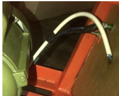
Gambar.4.22. Kabel Motor Listrik.
