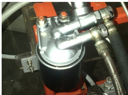
Gambar. 4.14. Filter Solar pada dudukannya
