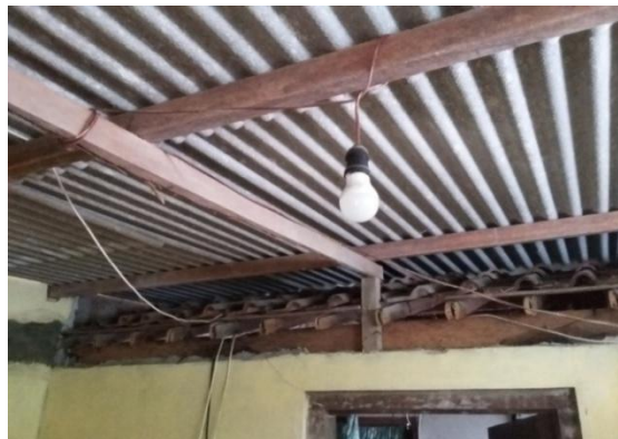
Gambar 4.35 Penutup atap asbes ( Sumber : Survei Lapangan 2018 )
