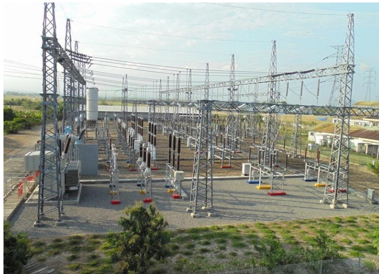
Gambar 2.1. Switchyard pada area Gardu Induk
