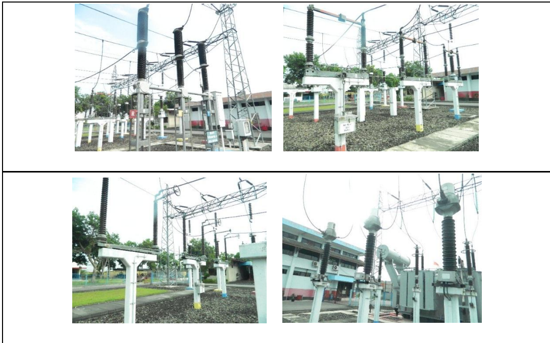
Gambar 4.1. Bay Trafo Gardu Induk 150 kV Bantul
