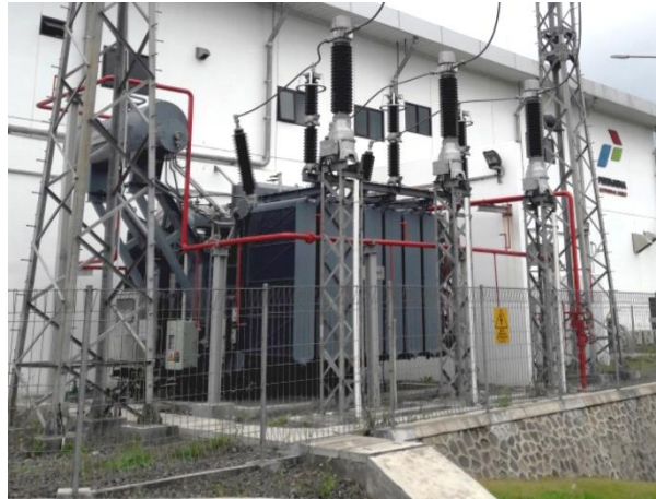
Gambar 2.2 Transformator Daya 50 MVA Pembangkit Listrik Tenaga Panas Bumi (PLTP) Kamojang Unit 5
