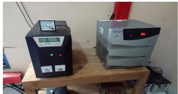
Gambar 4.9 Inverter 3,5 KW 48 V (Sumber: Dokumentasi pribadi)
