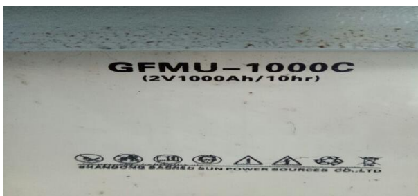
Gambar 4.8 Baterai atau Aki sun power 1000 Ah/12 V (Sumber: Dokumentasi pribadi)
