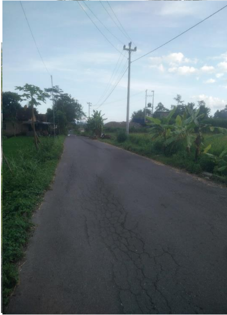
Gambar 4.39. Kondisi jalan jalur evakuasi segmen 6
