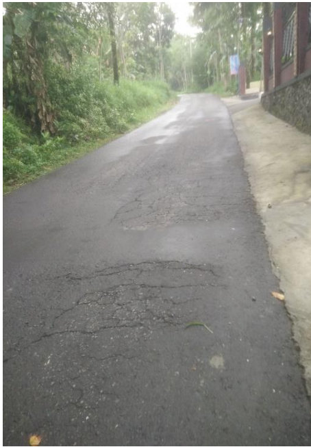
Gambar 4.2. Kondisi jalan jalur evakuasi segmen 1
