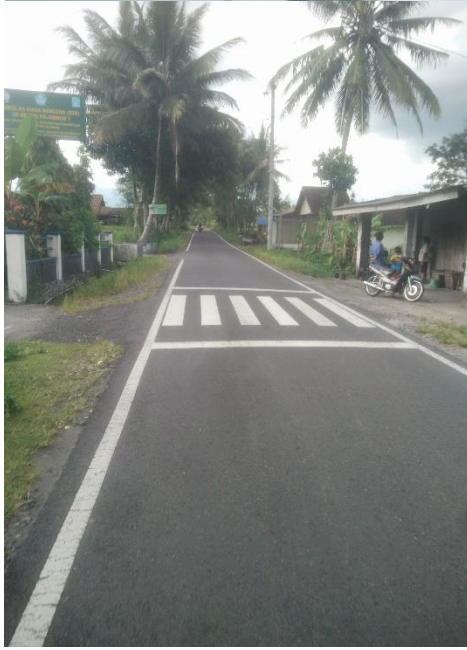
Gambar 4.32. Kondisi jalan jalur evakuasi segmen 5
