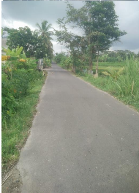
Gambar 4.25. Kondisi jalan jalur evakuasi segmen 4
