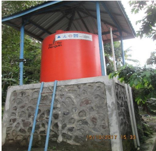
Gambar 4.93 Tempat penampungan air
