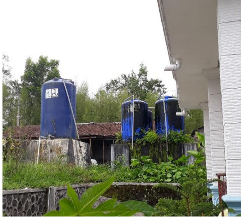
Gambar 4.41 Tempat penampungan air
