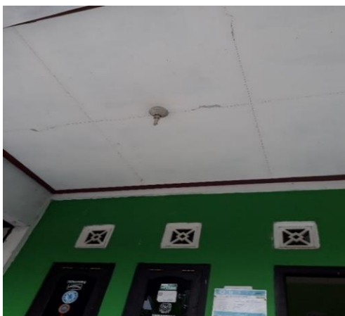
Gambar 4.103 Rusak pada plafon rumah di Huntap Banjarsari
