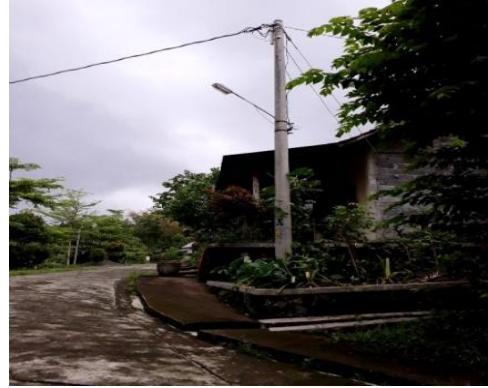
Gambar 4.4 Fasilitas penerangan jalan
