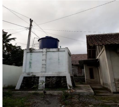
Gambar 4.80 Tempat penampungan air
