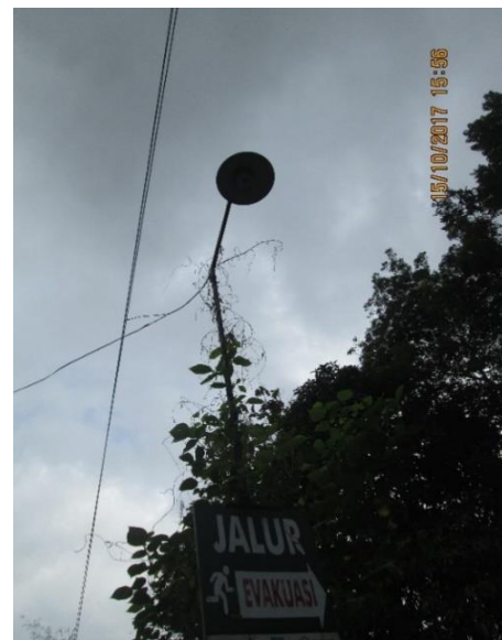
Gambar 4.92 Fasilitas penerangan jalan
