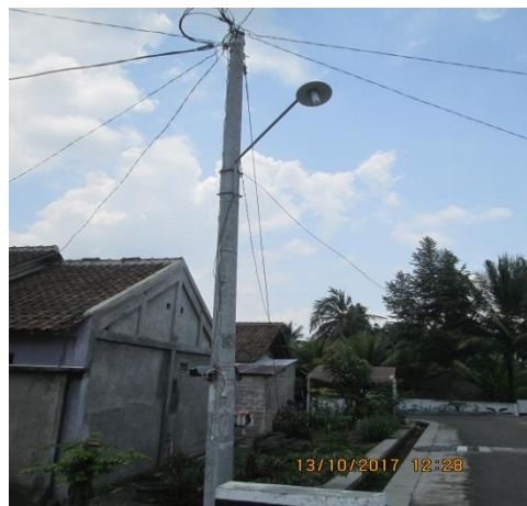
Gambar 4.10 Lampu penerangan jalan
