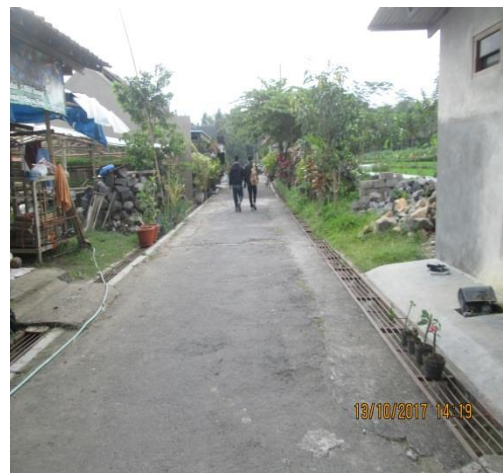
Gambar 4.32 Kondisi jalan lingkungan dan drainase.
