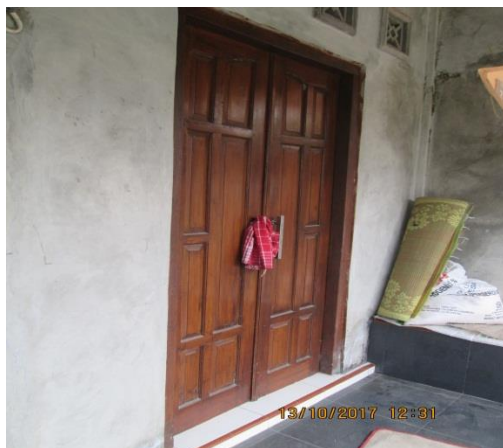
Gambar 4.19 Kondisi kusen dan panil pintu yang menggunakan kulit kayu yang baik.
