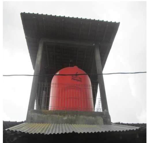
Gambar 4.30 Penampungan air bersih
