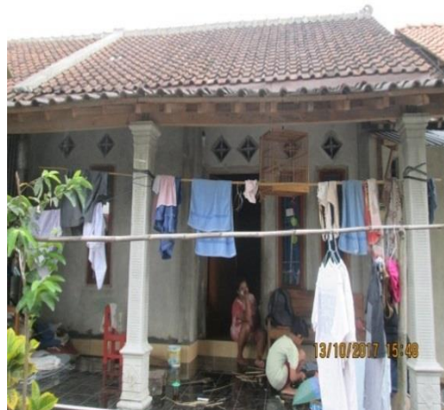
Gambar 4.72 Kondisi dinding dengan plesteran.
