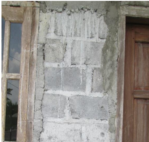
Gambar 4.15 Kondisi dinding tanpa plesteran.
