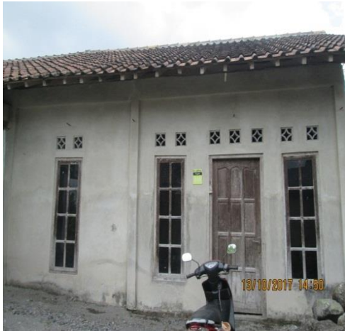
Gambar 4.95 Kondisi dinding dengan plesteran.
