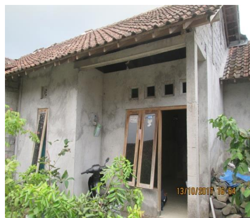
Gambar 4.128 Kondisi dinding dengan plesteran.
