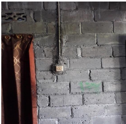
Gambar 4.40 Kondisi dinding tanpa plesteran.
