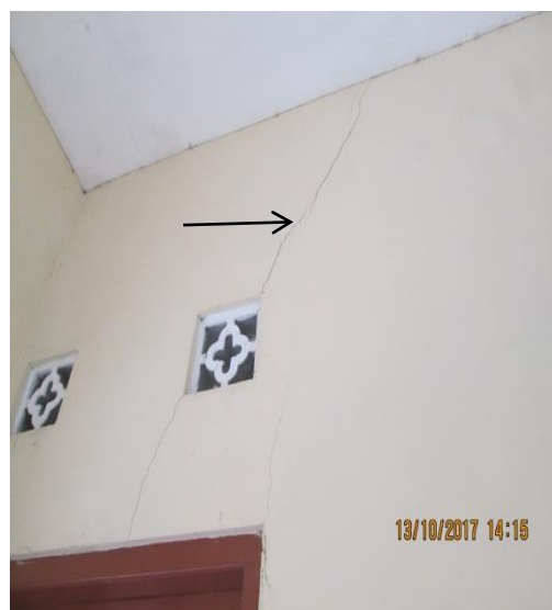
Gambar 4.49 Keretakan pada plesteran dinding balai warga huntap Jelapan.
