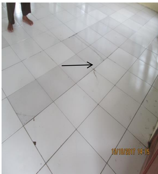
Gambar 4.48 Kerusakan pada penutup lantai balai warga huntap Jelapan.
