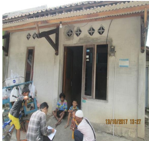
Gambar 4.16 Kondisi dinding dengan plesteran.
