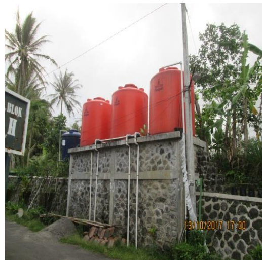
Gambar 4.110 Penampungan air bersih
