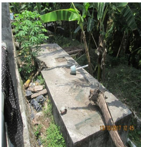
Gambar 4.7 Instalasi Pengolahan Air Limbah (IPAL Komunal)
