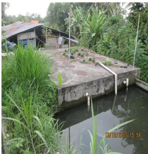
Gambar 4.58 Instalasi Pengolahan Air Limbah (IPAL Komunal)
