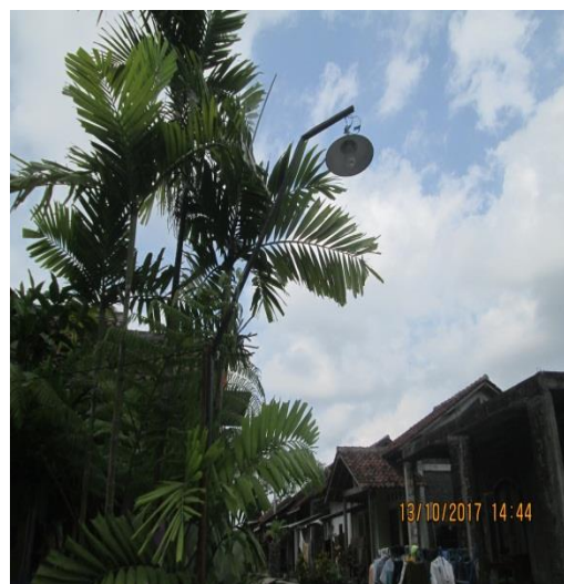
Gambar 4.88 Lampu penerangan jalan.
