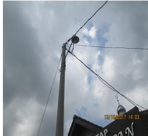
Gambar 4.34 Lampu penerangan jalan
