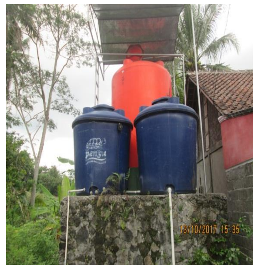
Gambar 4.57 Penampungan air bersih
