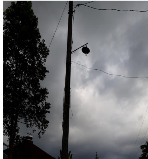
Gambar 4.61 Lampu penerangan jalan
