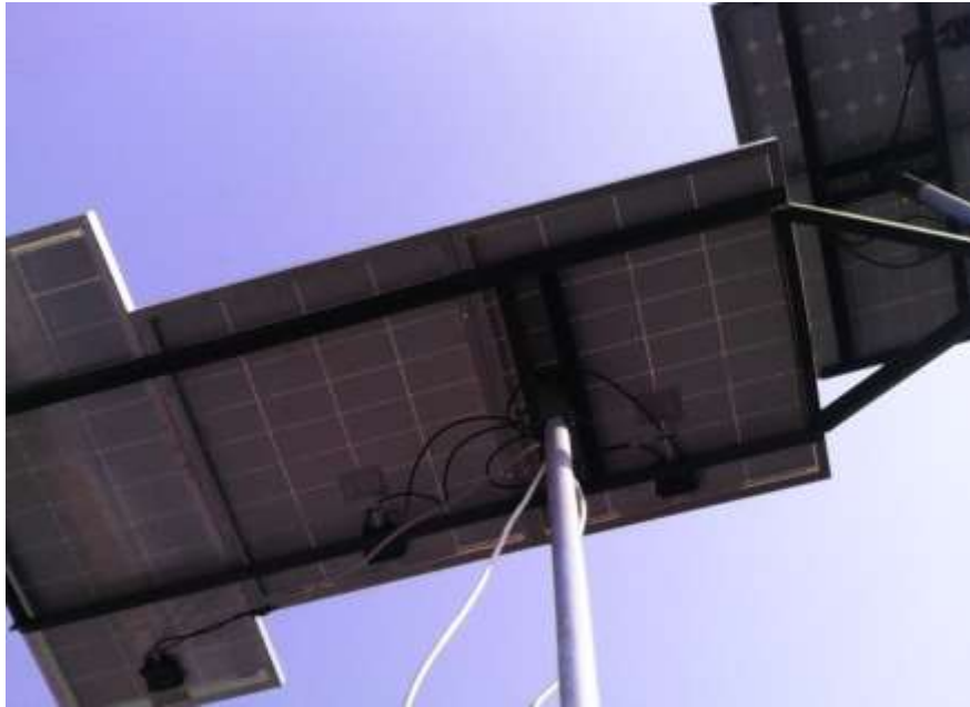
Gambar L.3. Solar cell panel 800 Wp telah terpasang di UKM Batik Ida Lestari.
