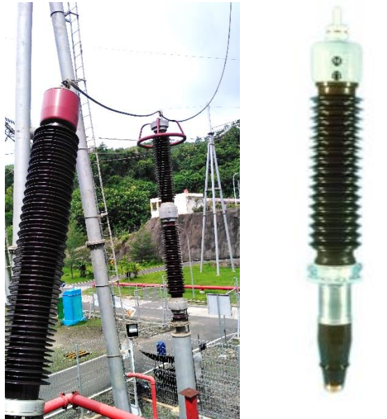
Gambar 2.10 Bushing pada Transformator Dokumen Penelitian di PLTU 1 PACITAN
