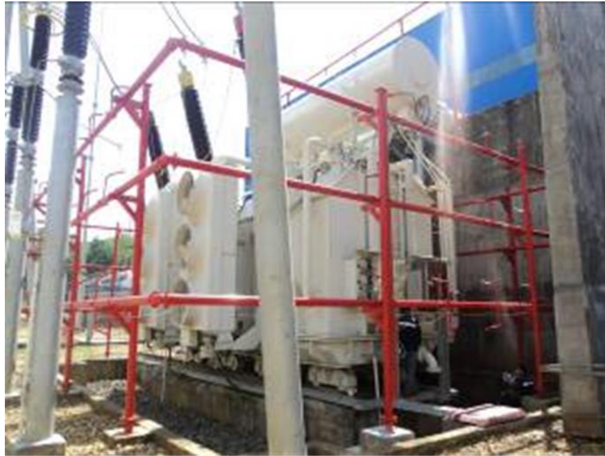
Gambar 2.25 Trafo GT ( Generator Transformer ) Sumber: Dokumen Penelitian di PLTU 1 PACITAN
