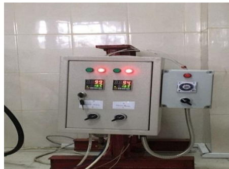
Gambar 3.2 pengaturan suhu pada panel
