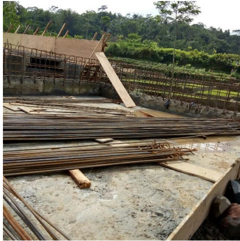
Gambar 4.10 Material yang ditinggalkan di lokasi tanpa pengawasan
