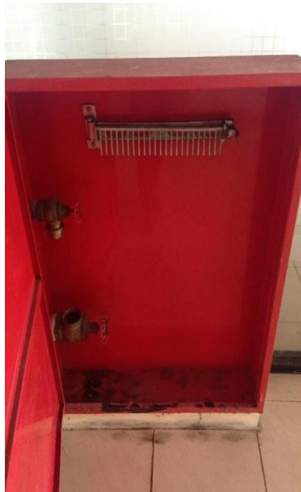
Gambar 4.1 Hydrant lantai dasar (Selatan gedung)
