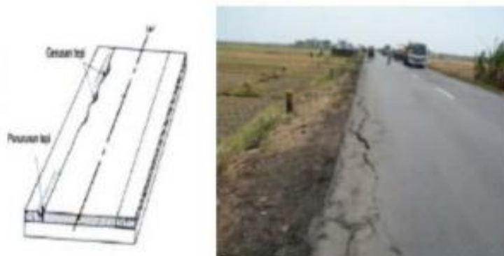
Gambar 2.17 Retak Samping Jalan ( Edge Cracking )
