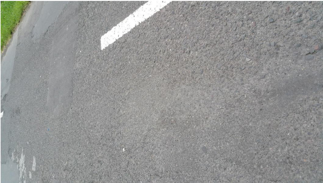
Gambar 6. Kerusakan Pengausan Agregat
