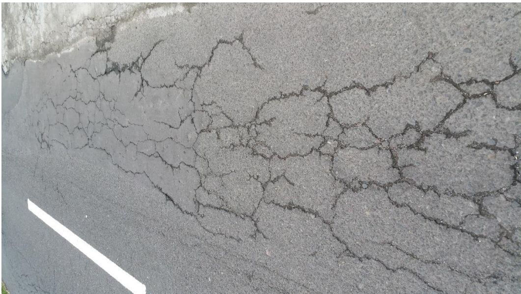
Gambar 2. Kerusakan Retak Kulit Buaya
