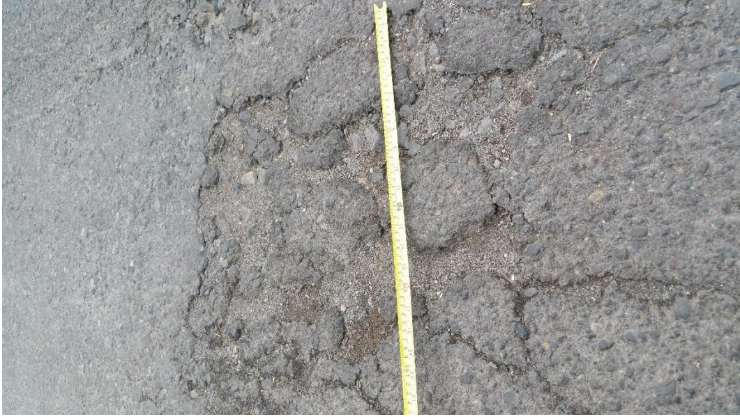
Gambar 11. Kerusakan Pelepasan Butir
